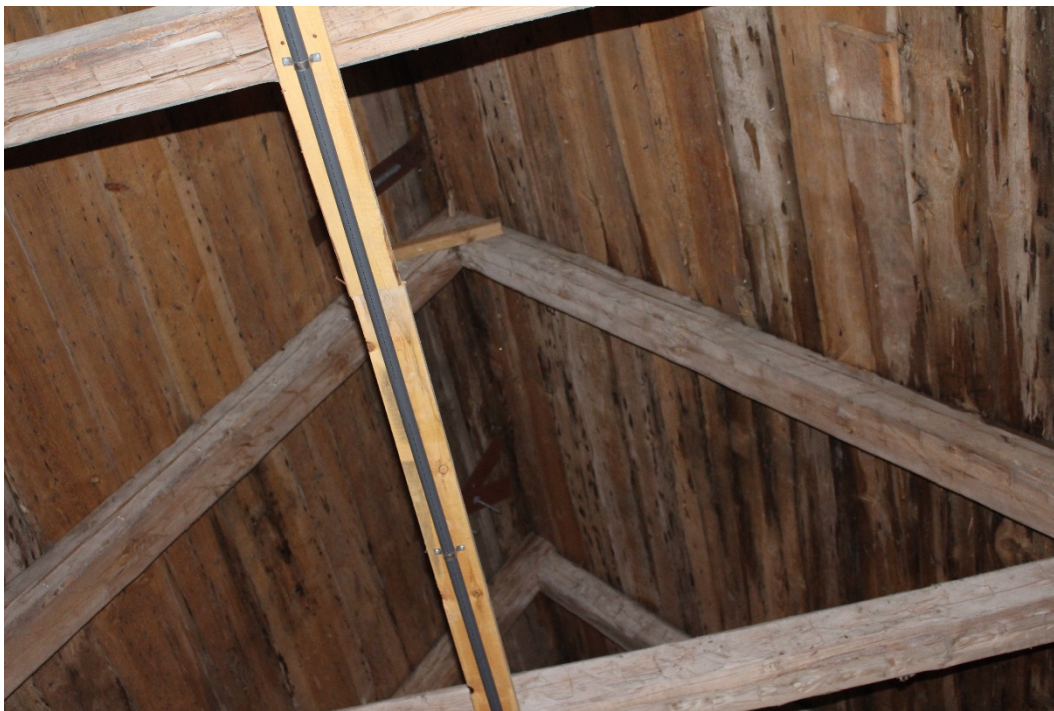
Bild 2: Förläggning av samplingsrör för ett aspirerande branddetektionssystem i ett vindsutrymme. Foto: Magnus Arvidson, RISE.
