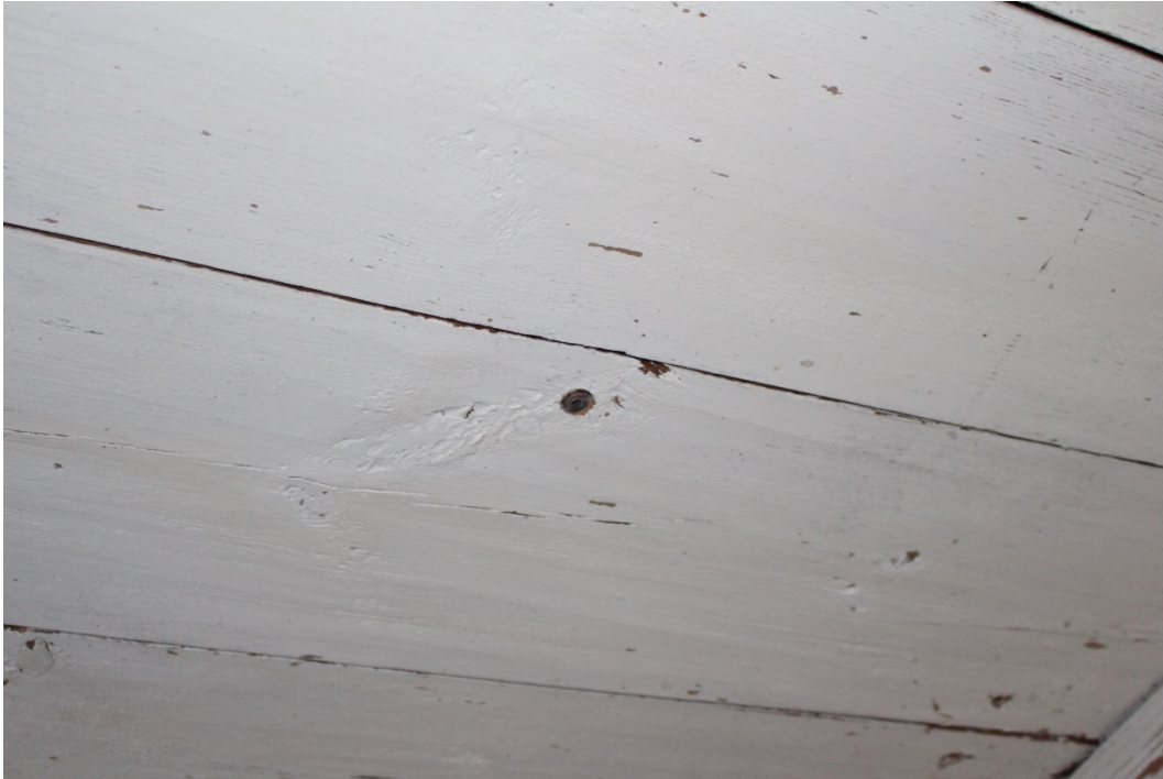
Bild 3: Dold förläggning av samplingsrör för ett aspirerande branddetektionssystem i ett golvbjälklag med samplingsöppning till röret genom takplankan. Denna förläggning kräver att golvplankor på våningen ovanför demonteras. Foto: Magnus Arvidson, RISE.
