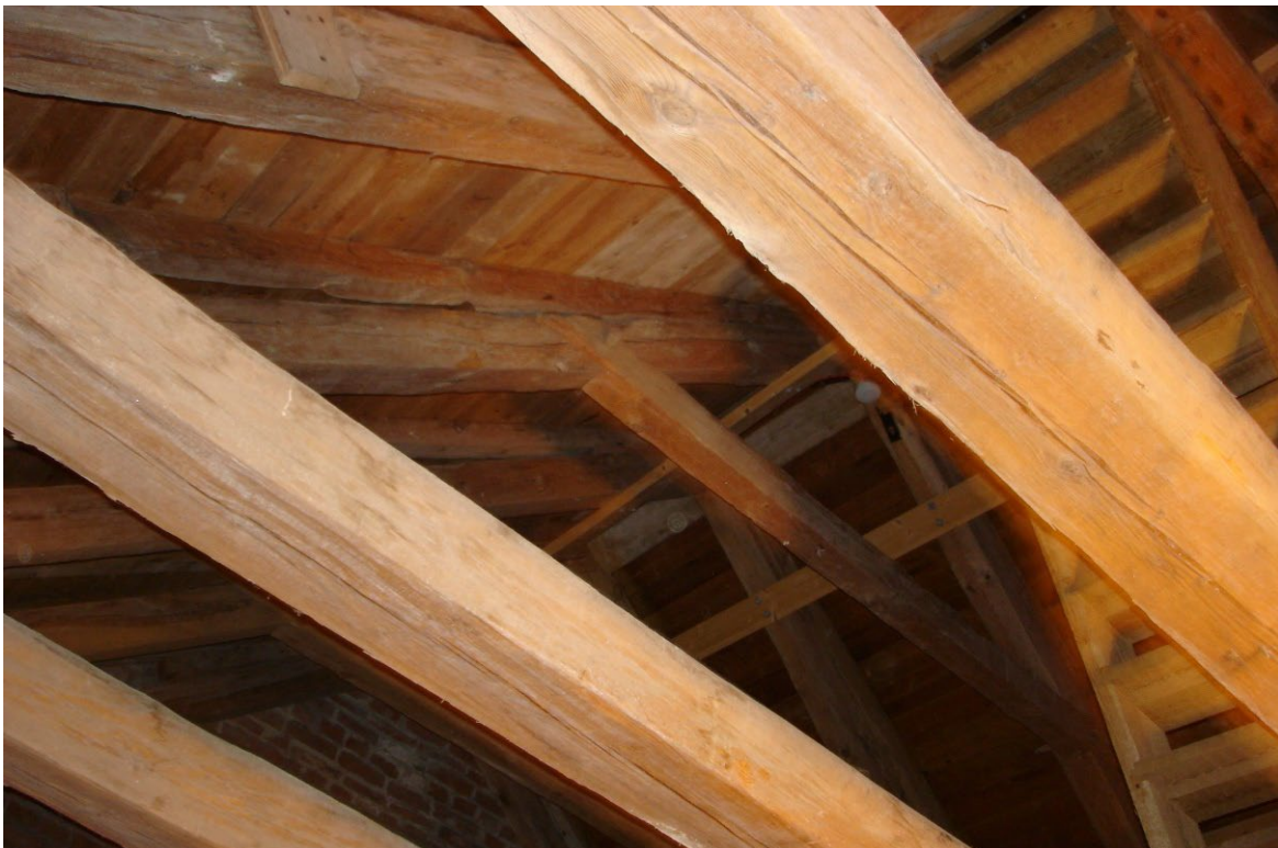
Bild 9: Vindsutrymmen i större kulturhistoriskt värdefulla byggnader innebär stora utmaningar avseende placering och val av sprinkler. Foto: Magnus Arvidson, RISE.
