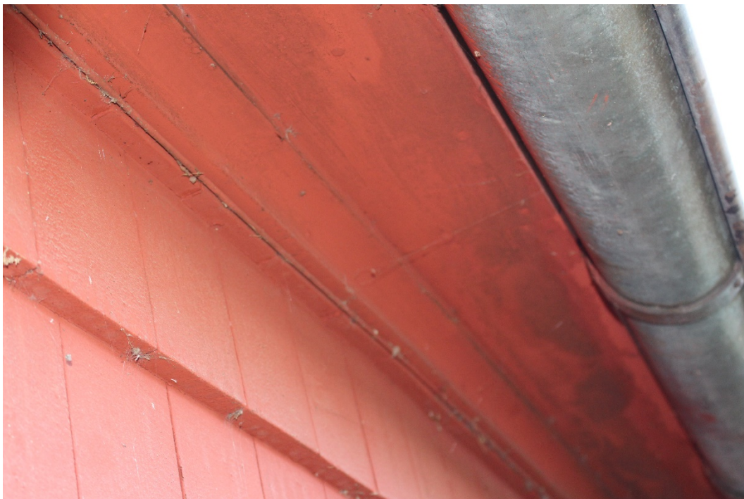
Bild 1: Värmedetektionskabel installerad under takfoten på 1600-tals träkyrka. Diskret förläggning men ej optimalt för tidig detektion eftersom kabeln ligger direkt mot underlaget och nära väggen. Foto: Magnus Arvidson, RISE.
