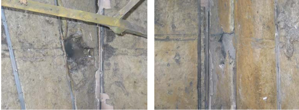
Figur 5. Skador av krevad från fyrverkeripjäser (ca 30-40 cm i diameter).
