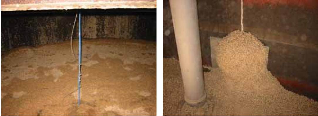
Figur 43 Foton som visar kondensbildning i pelletsen på silotoppen efter försöken samt ”kakkbildning” på insidan av läckageöppningen vid silobotten.
