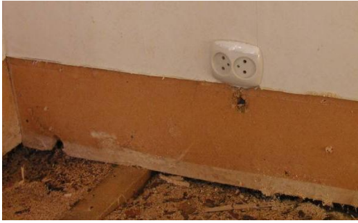
Figur 5: Bilden visar ett likadant vägguttag på motsatt vägg i sovrummet.
